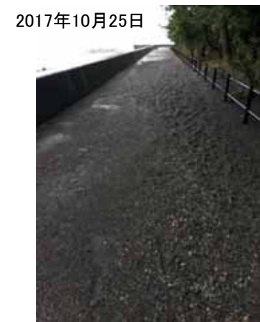
堤防背後の管理用通路へ運ばれた大量の砂礫
