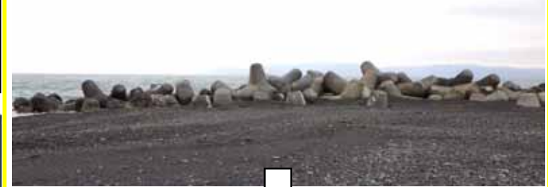
【1号消波堤復旧前】平成30年2月22日撮影
