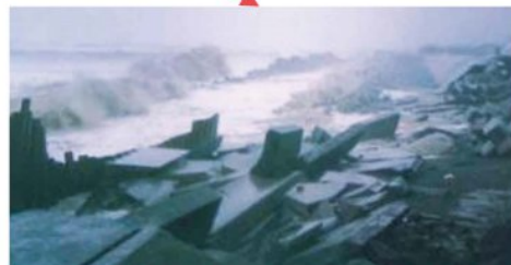
台風による海岸侵食の被災(昭和58年 静岡市清水区蛇塚)
