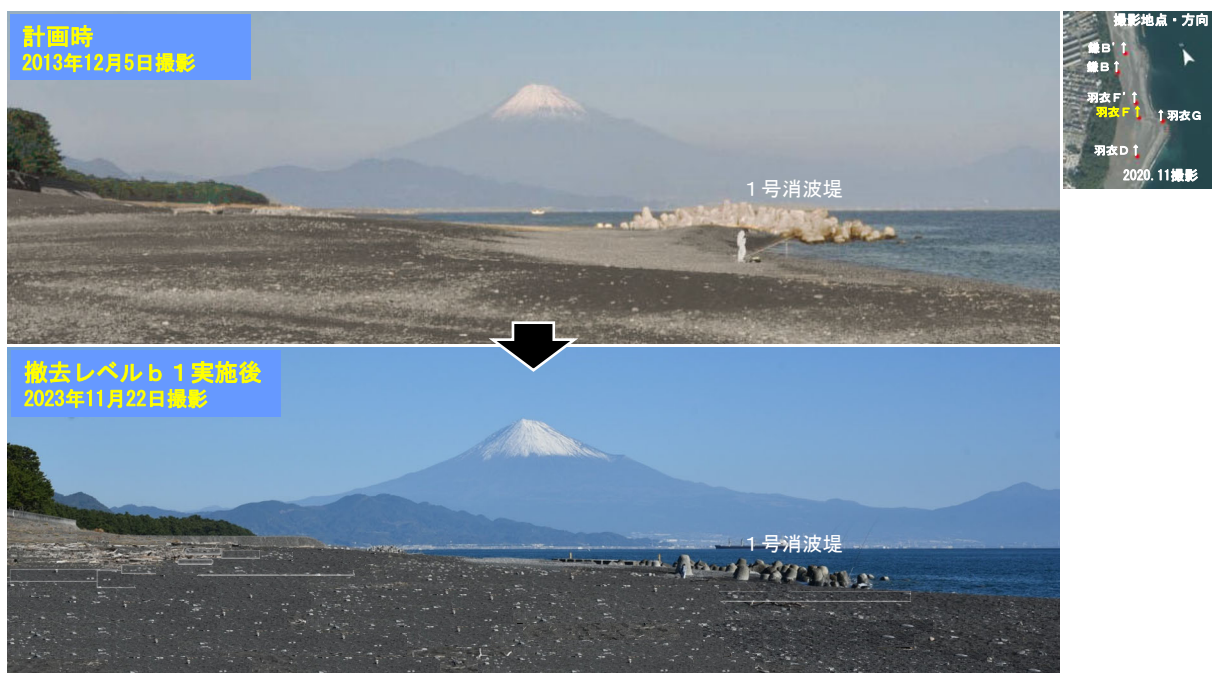
図 2.5 景観対策としての1号消波堤のブロック撤去（第10回FU会議資料）
