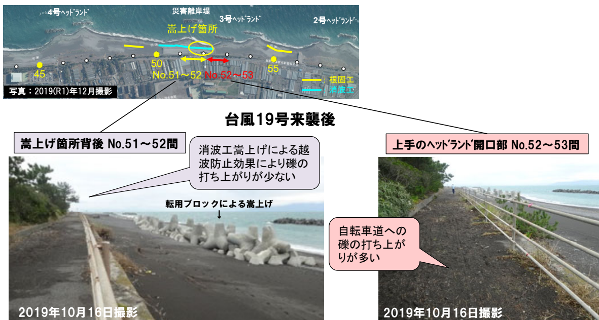
図 2.60 転用ブロックによる消波工の嵩上げによる越波防止の効果
